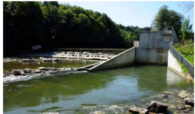
Abbildung 87: Wehr des KW Burentobel vom Unterwasser aus gesehen. In der Bildmitte: der Eingang zum Fischpass.
