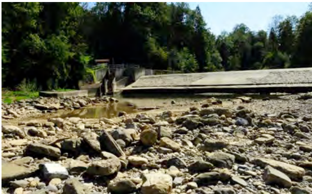
Abbildung 88: Das Wehr des KW Erlenholz bei Sunk vom Unterwasser aus gesehen. Auf der linken Seite ist die Fischaufstiegsanlage zu sehen.
